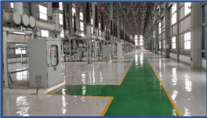
动力工区开关站
